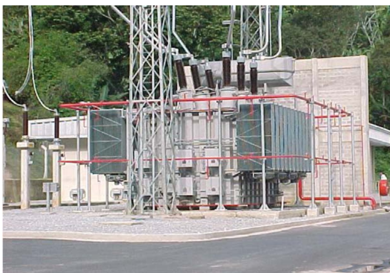
Рисунок 3.4 – Фазопоротный трансформатор напряжением 138 кВ проходной мощностью 400 МВА на подстанции Angra dos Reis
