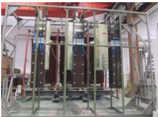
Рисунок 4.2 – Сухой трансформатор 69 кВ, 25 МВА с РПН
