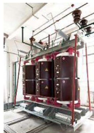
Рисунок 4.3 – Сухой трансформатор 45 кВ, 10 МВА с ПБВ
